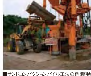
■サンドコンパクションパイル工法の例(駆動式SPC工法)
